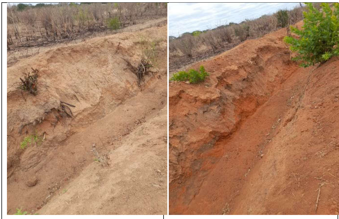
Figura 4: Paredes da trincheira sofrendo de erosão.
